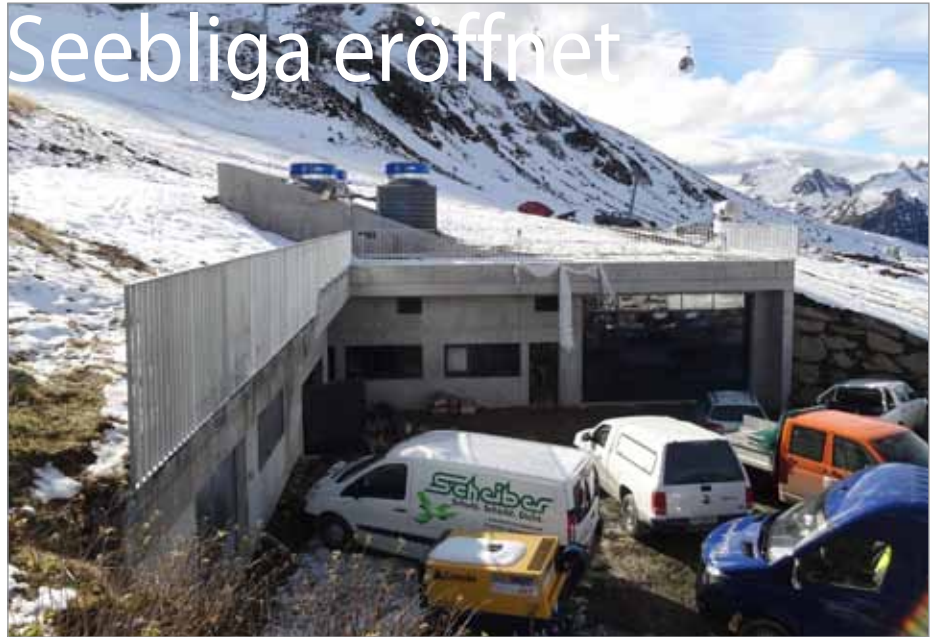
Die Pisten im Bereich Seebliga, Sennigrat und auch die Pisten im Grasjoch-Gebiet werden nunmehr von dieser leistungsstarken Pumpstation aus versorgt. Fotos: KLENKHART & Partner
