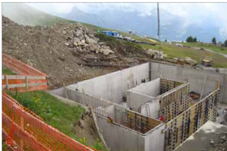
Das Gebäude für die neue Pumpstation beim Speicherteich Seebliga auf 1.970 m See-Höhe.
