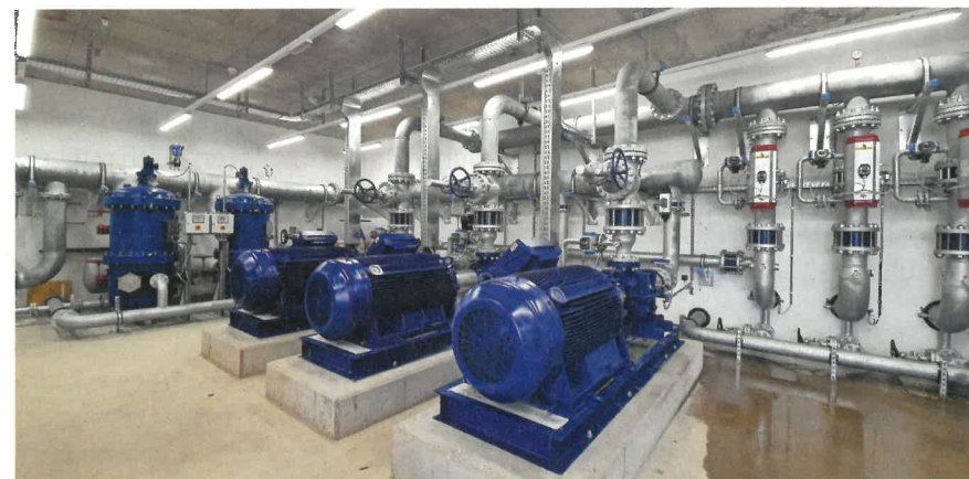
Pumpstation für die technische Beschneigung für das Skigebiet Gargel der Gargellner Bergbahnen
